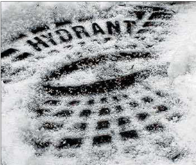
Schneebedeckter Unterflurhydrant Foto: OVB - Feuerwehr
