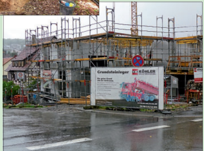
Die Rohbauarbeiten für das neue Pflegeheim im Dachteler Ortskern stehen kurz vor dem Abschluss.
